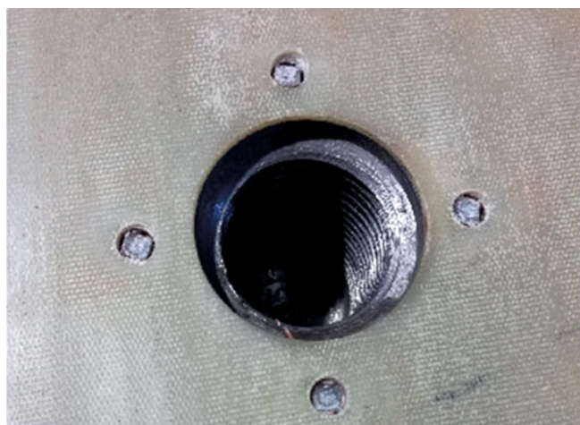
Рис. 4. Текстилитовая прокладка зеркального диска подпятника гидрогенератора с текстилитовыми технологическими пробками
