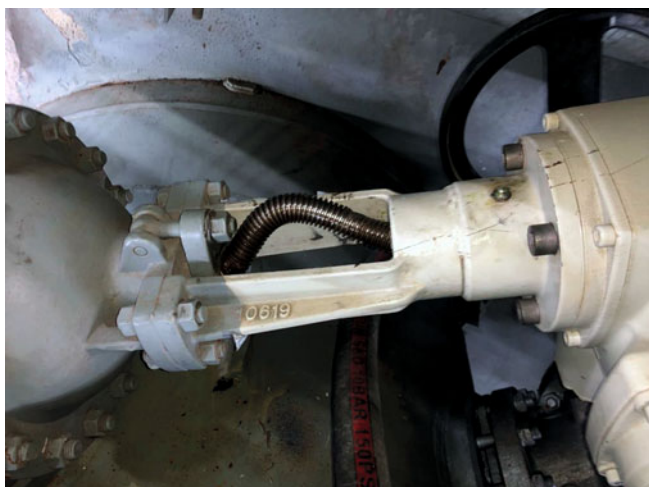
Рис. 12. Повреждение штока ремонтной задвижки (с электроприводом) байпаса дискового затвора.
